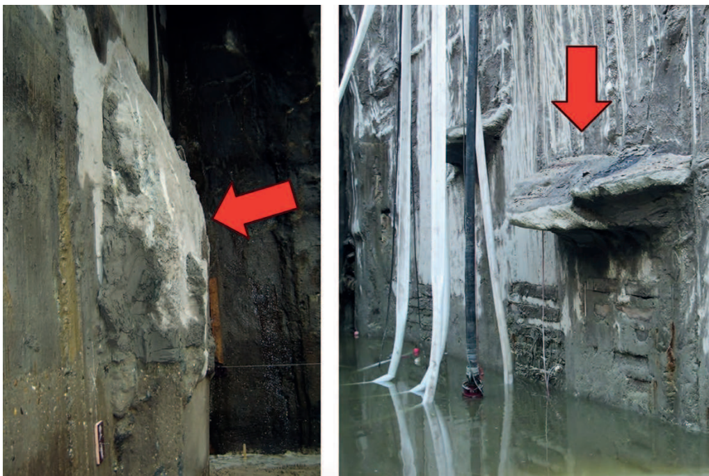
Abbildung 17: Bodeneinbruch unter Leitwand bzw. bei Wandherstellung
