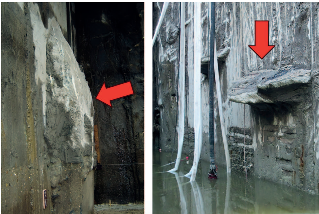
Abbildung 17: Bodeneinbruch unter Leitwand bzw. bei Wandherstellung
